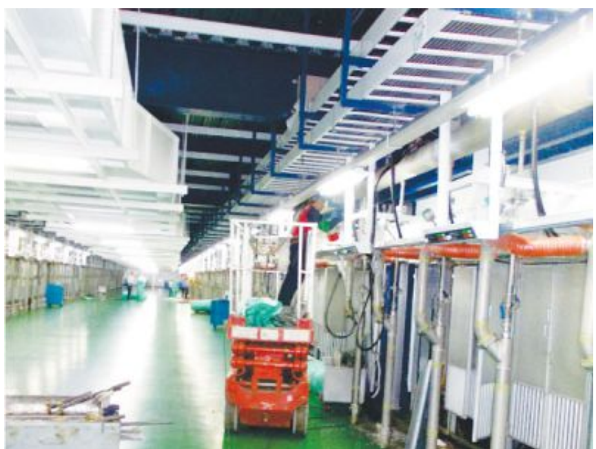
HÌNH ẢNH THI CÔNG LẮP ĐẶT HỆ THỐNG CHIẾU SÁNG NHÀ MÁY
