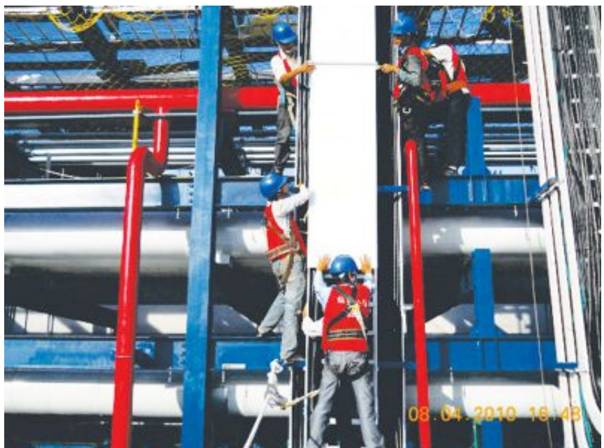
HÌNH ẢNH THI CÔNG LẮP ĐẶT MÁNG CÁP - KÉO CÁP ĐIỆN NHÀ MÁY
